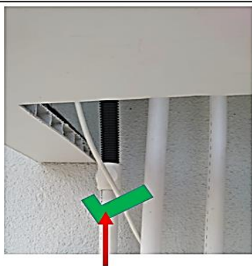
Yoğuşma suyu gider borusu sızdırmaz ve sıkı geçme olmalıdır
